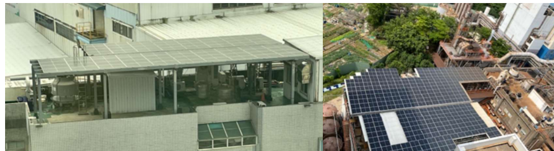
▼台耀太陽能發電裝置
